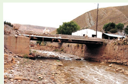
Precariedad del puente de paso vehicular antiguo
