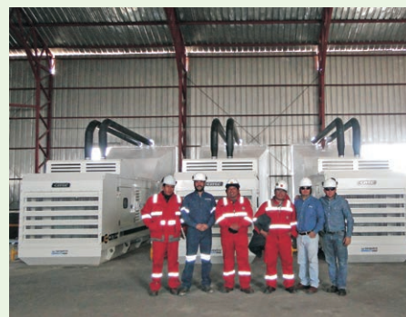
Trabajadores de la GNRE junto a generadores a GLP
