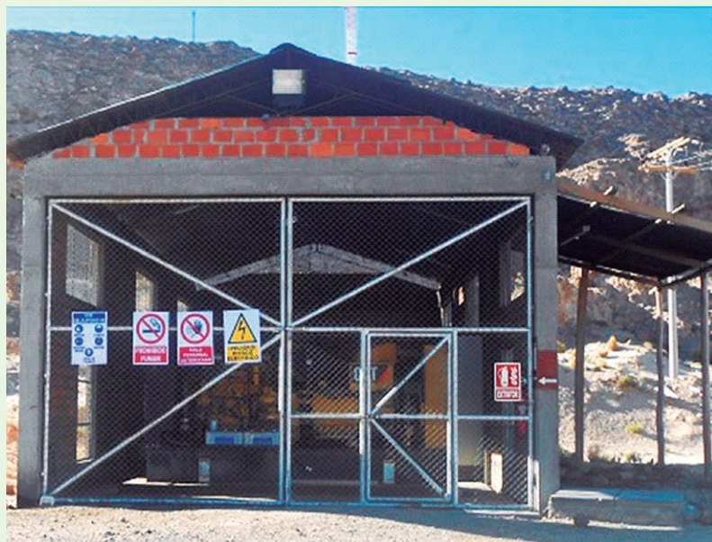
Señalización preventiva instalaciones de generador eléctrico
