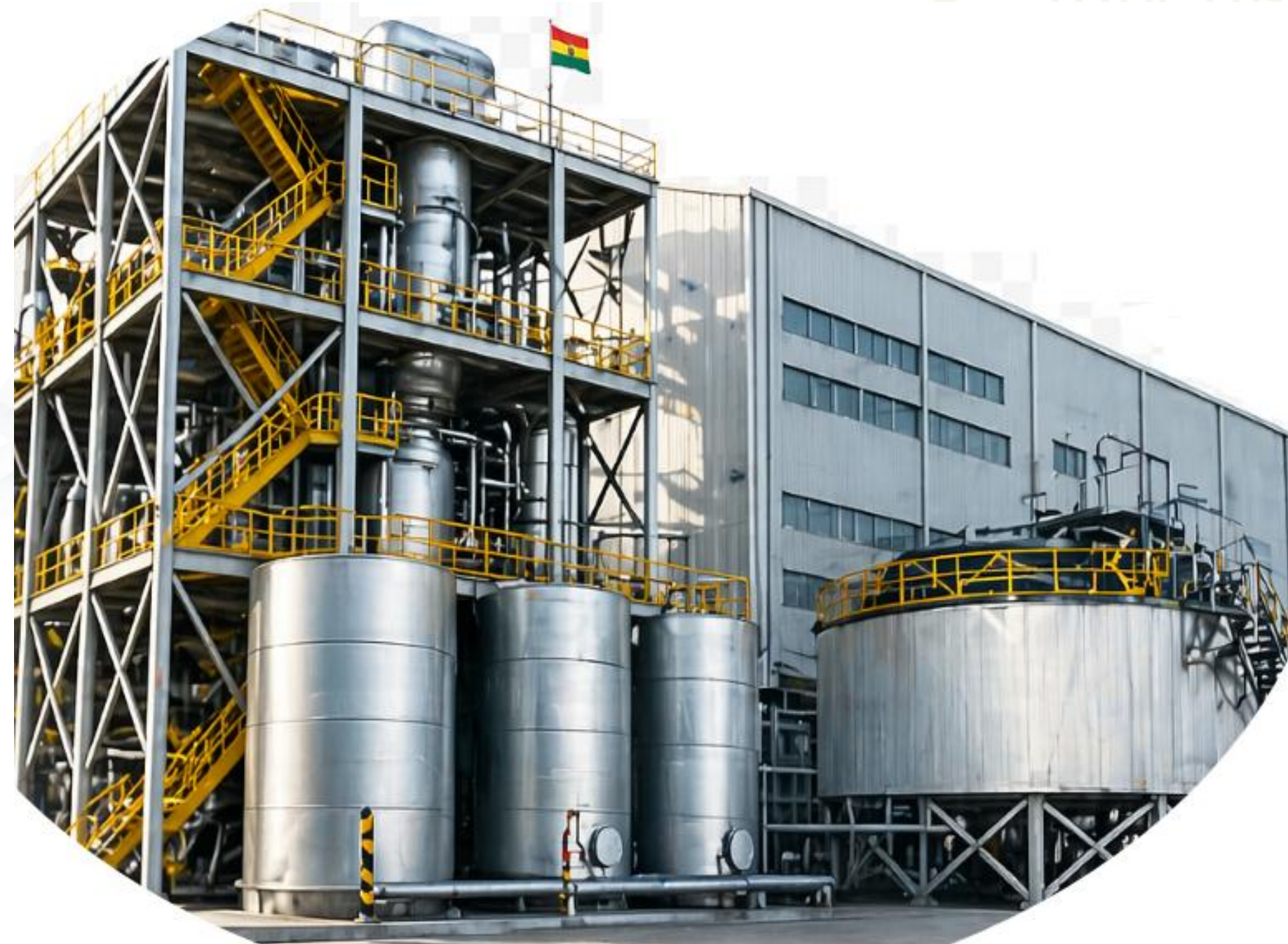
Planta Industrial de Carbonato de Litio
